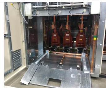
Рис. 7 Отсек присоединений ВССШ
