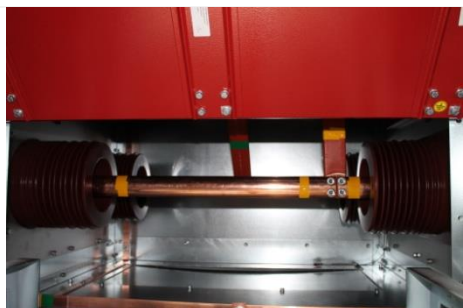
Рис. 3 Отсек сборных шин НССШ (вид при извлеченном ВЭ и снятой перегородки)
