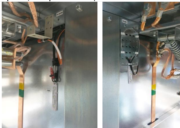
Рис.4 Оптический датчик в отсеке присоединений
