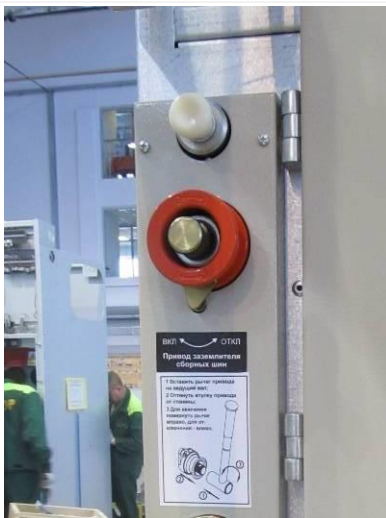
Рис. 2.15 Гнездо привода заземлителя СШ
