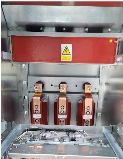
Рис. 3.4 Вид высоковольтного отсека при открытой двери
