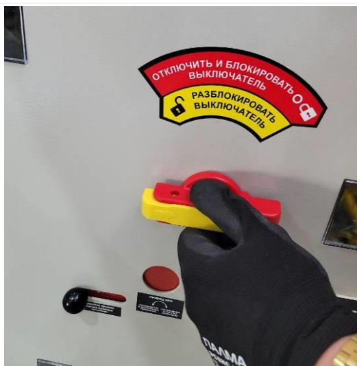
Рис. 2.25 Ручное отключение выключателя с фасада шкафа
