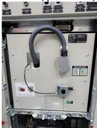
Рис.1.16 КВЭ в контрольном положении (вид при открытой двери)
