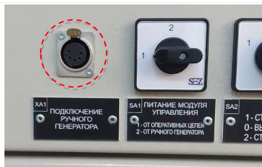
Рис. 2.27 Разъем для подключения ручного генератора на фасаде релейного отсека
