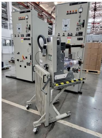
Рис.1.17 КВЭ в ремонтном (сервисном) положении
