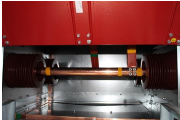
Рис. 25 Отсек сборных шин
