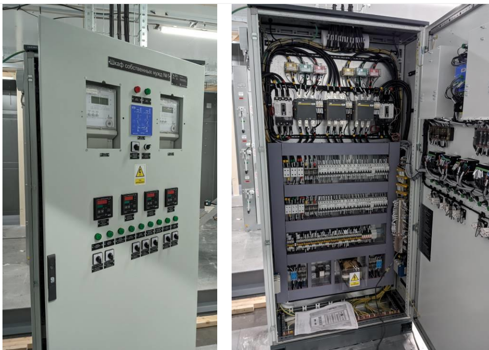
Рис. 49 Шкаф собственных нужд
