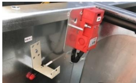
Рис.13 Комбинированная защита от дуговых замыканий (клапанная и волоконно-оптическая) в отсеке сборных шин
