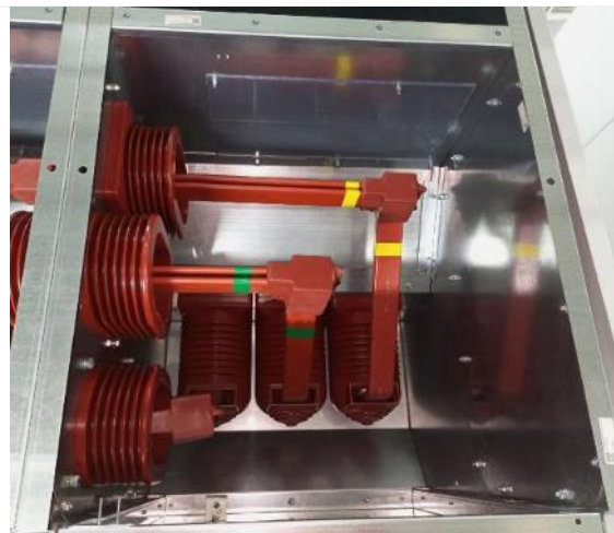
Рис.3 Отсек сборных шин в крайнем шкафу секции КРУ (вид сверху при снятых клапанах сброса давления)
