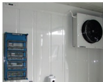
Система принудительной вентиляции
