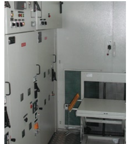
Тележка-подъемник для КРУ 6(10) кВ
