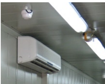
Системы основного и аварийного освещения, кондиционирования и пожарной сигнализации
