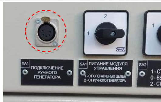
Рис. 2.28 Разъем для подключения ручного генератора на фасаде релейного отсека
