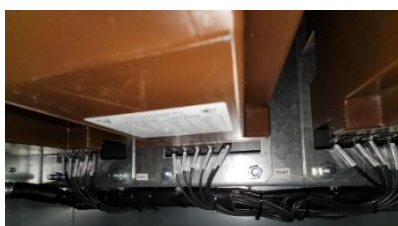
Рис.3.10 Крепление трансформаторов тока
