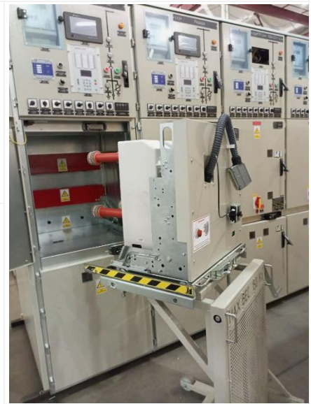
Рис. 2.20 КВЭ в ремонтном положении
