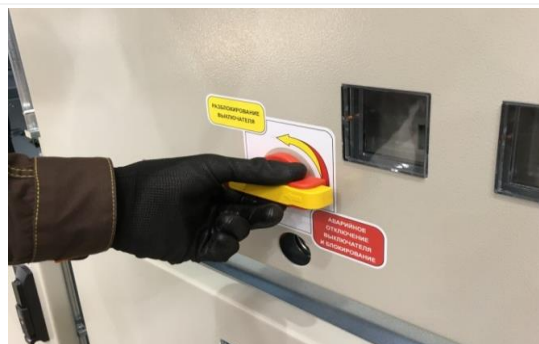
Рис. 2.26 Ручное отключение выключателя ISM25_Shell с фасада шкафа
