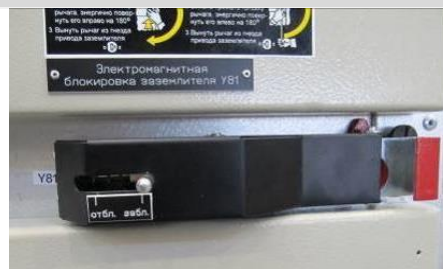
Рис.1.31 Электромагнитная блокировка заземлителя
