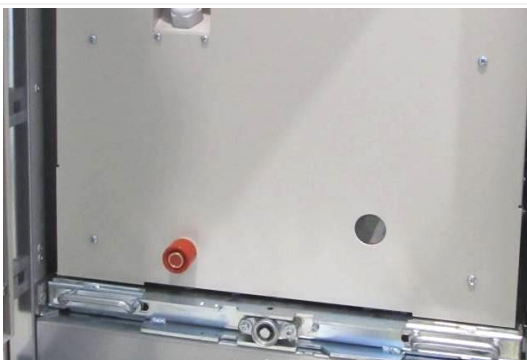
Рис. 2.25 Приемная кнопка ручного отключения выключателя (вид с открытой дверью отсека)
